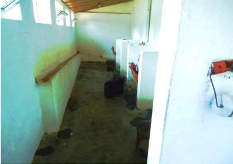
Taraz-Almatı arası bir restoranın tuvaleti... Kapı yok
